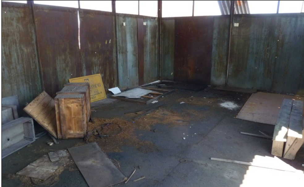
Obrázek 4: Vysoce kontaminované betony skladu olejů a maziv
