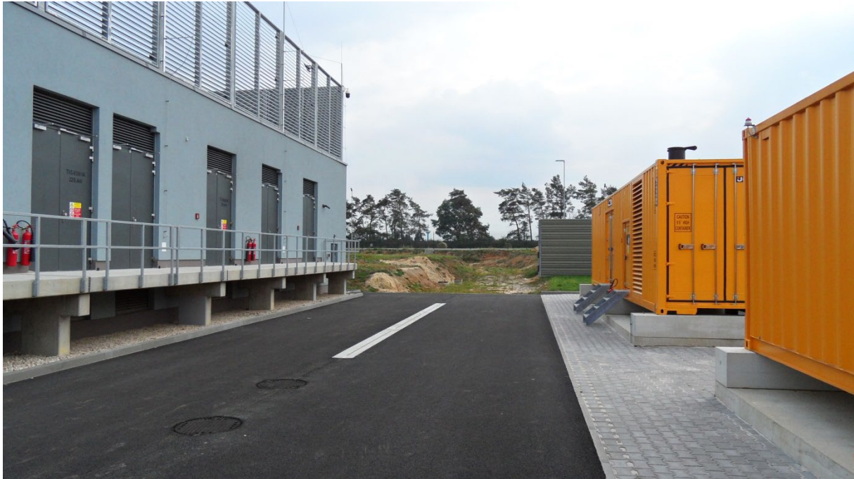
Vlevo zadní část budovy datového centra s trafostanicemi, vpravo energocentrum
