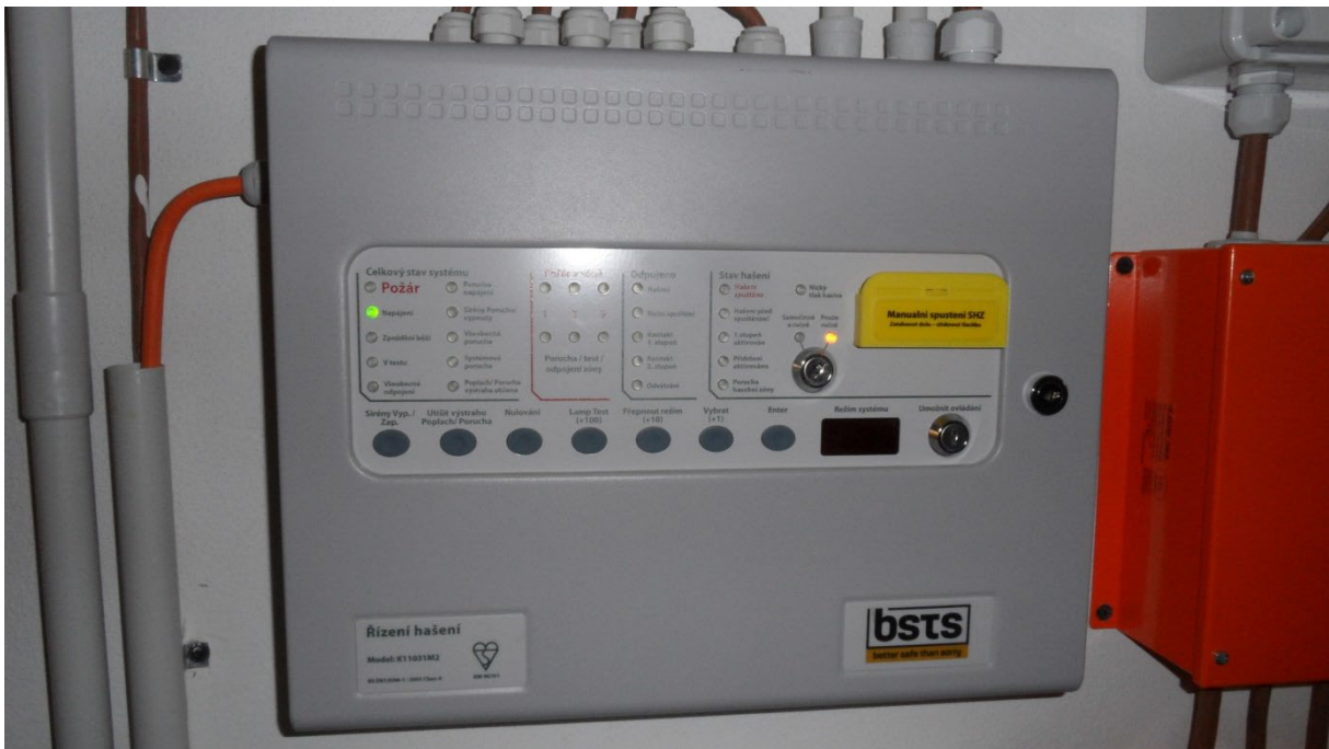
Ústředna stabilního plynového hasicího zařízení
