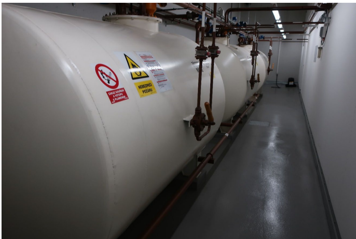
Skladovací nádrže nafty pro záložní diesela agregáty
