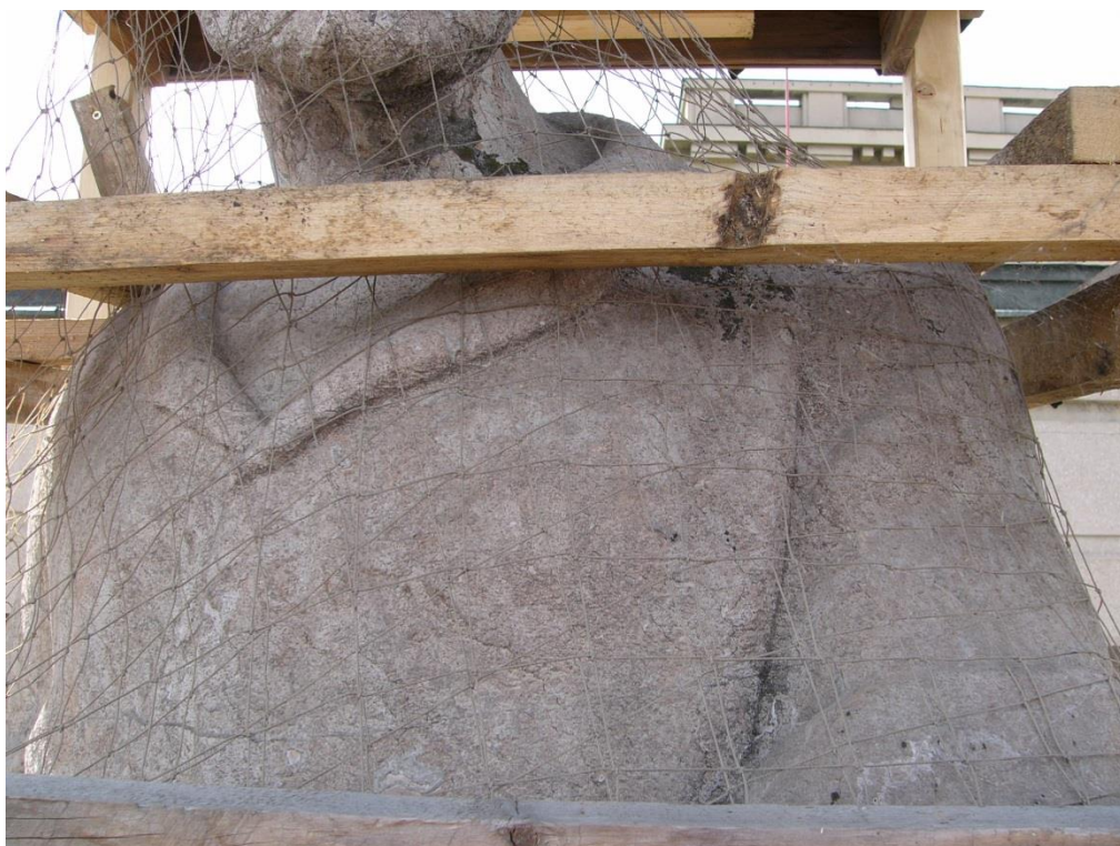
Horní část trupu ze předu: praskliny po celé ploše trupu
