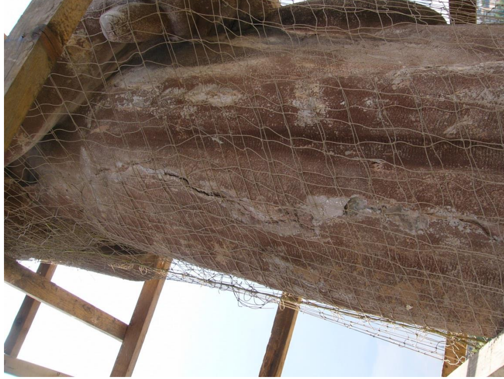
Drapérie z pravého předoboku: statická trhlina táhnoucí se po celé délce skulptury
