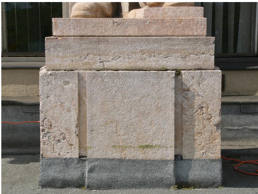
Sokl sochy ze předu: statické trhliny a degradace kamene v kvádrech soklu
