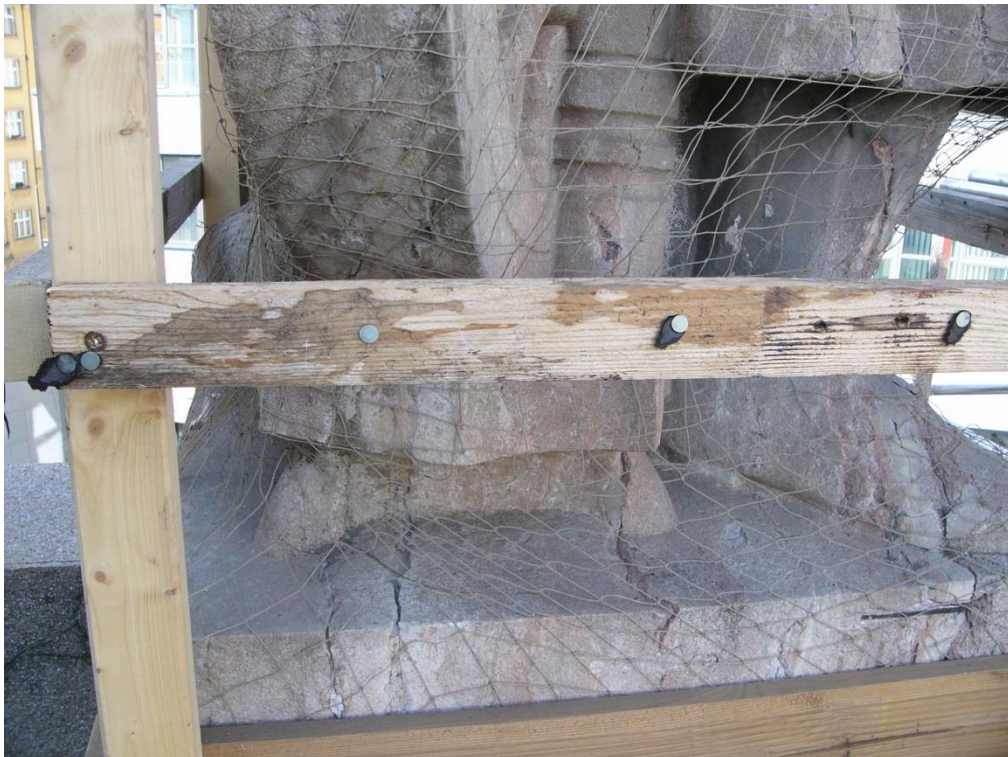
Spodní část z pravé strany: statické trhliny táhnoucí se přes plintus sochy i sochu samou
