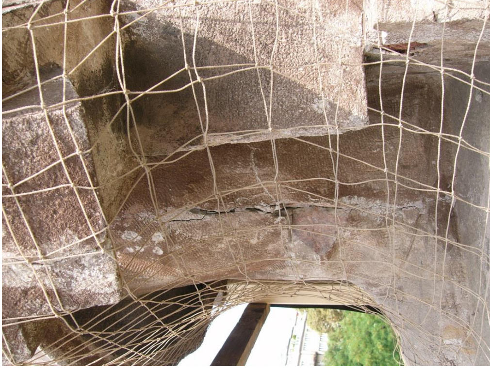
Levá noha z levé strany: viditelná statická trhlna způsobující odpadávání kamenného materiálu
