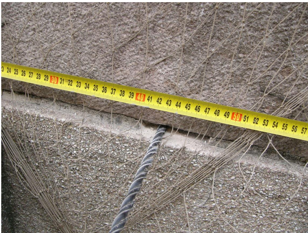
Vzdálenost vrtu a tím i kotvicího čepu od kraje plinty sochy
