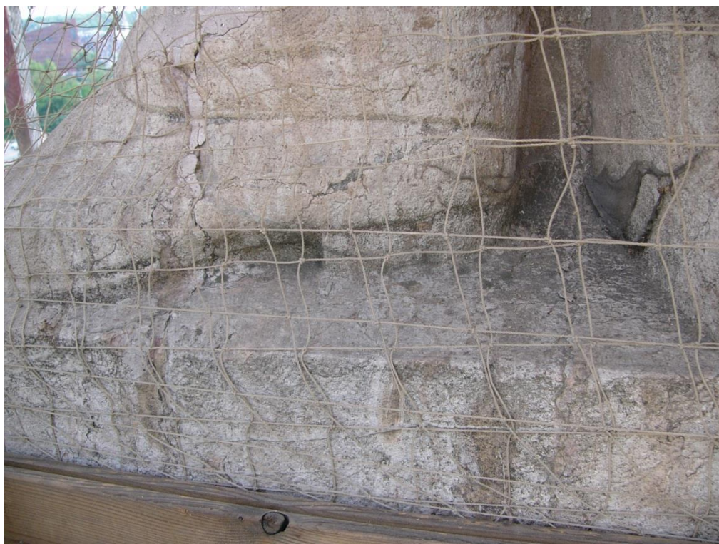
Detail levé boty z levé strany: statická trhlina a sítě drobných prasklin po celé ploše boty i plintusu sochy
