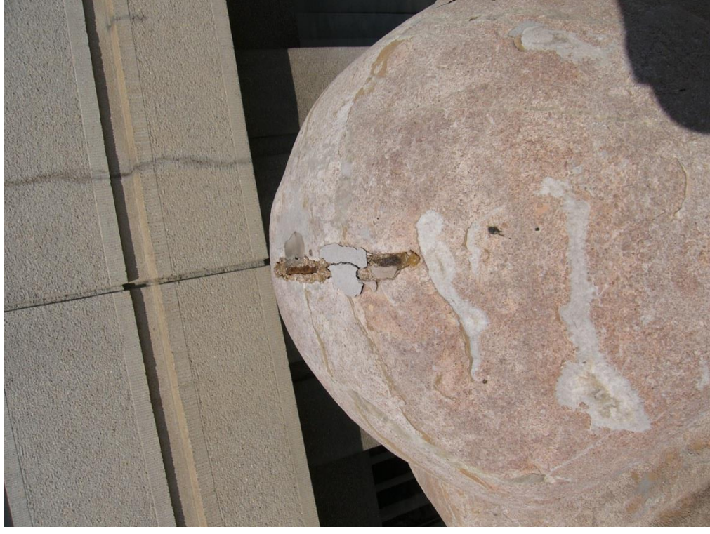
Detail pokrývky hlavy z nahledu: zkorodovaná zabezpečovací kramlička , zapříchující odpadávání materiálu, praskliny v celé ploše
