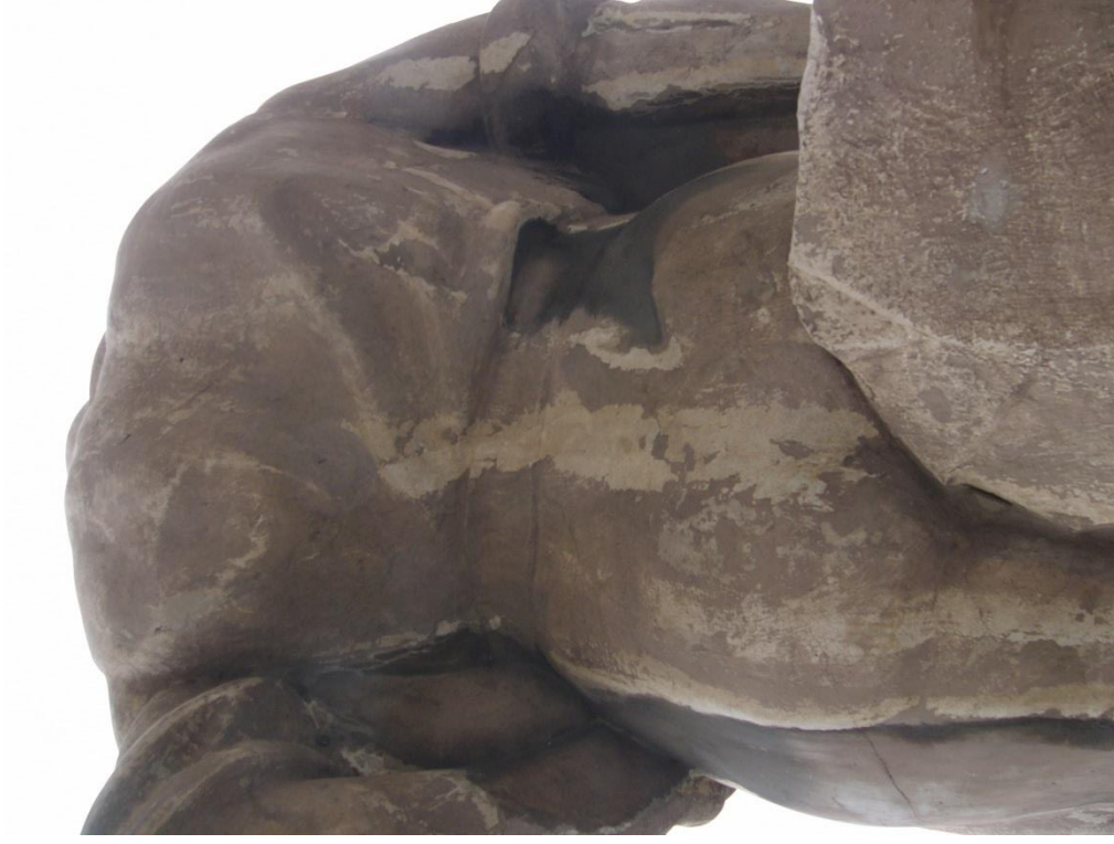
Zadní část trupu: krusta a drobné praskliny po celé oblasti zad
