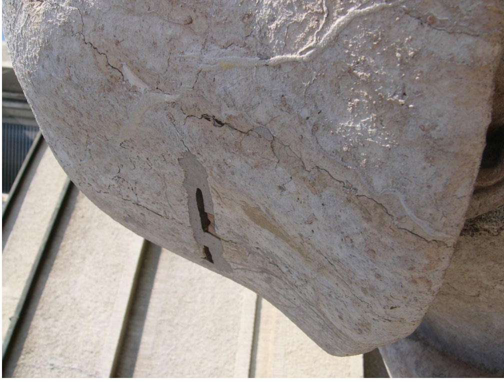
Detail klobouku: výrazné trhliny i drobné praskliny po celé ploše klobouku, zajišťující kramlíčka
