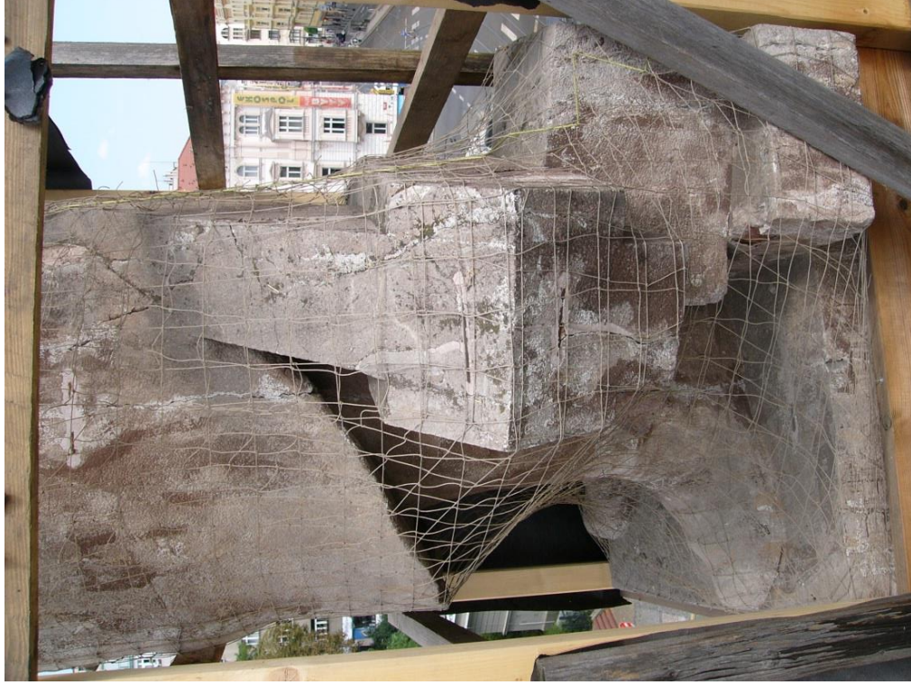
Nohy z levé strany: viditelné statické trhliny, pavučiny drobných prasklin, zajišťovací kramlíčky
