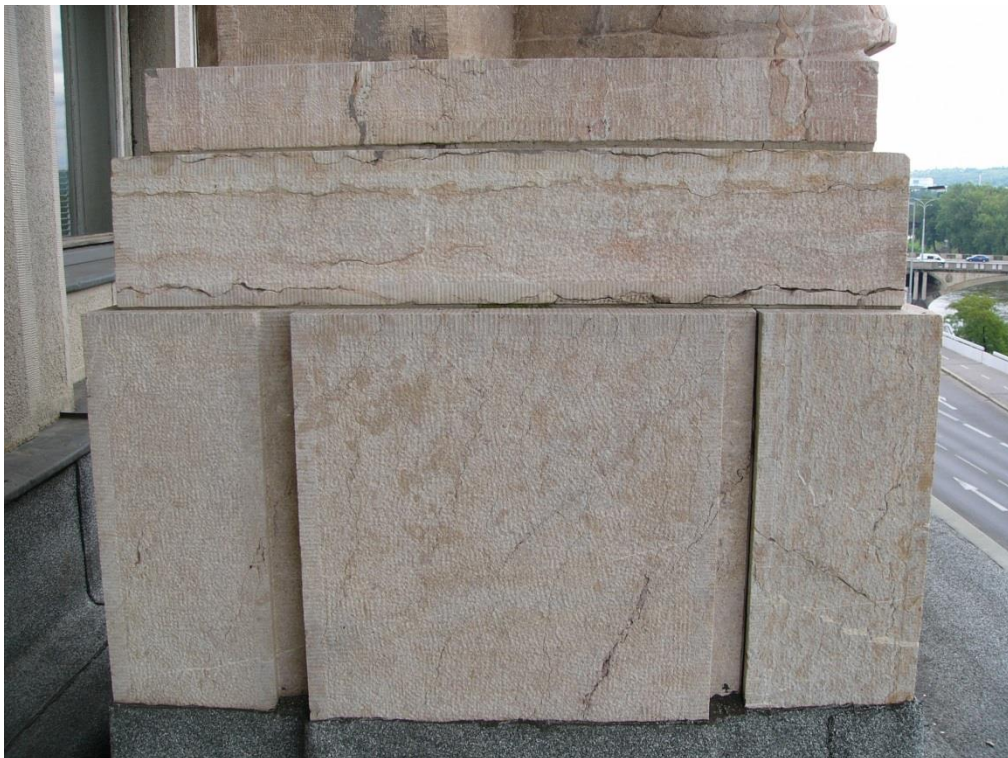
Sokl sochy z pravé strany: hloubkové trhliny v kvádrech soklu
