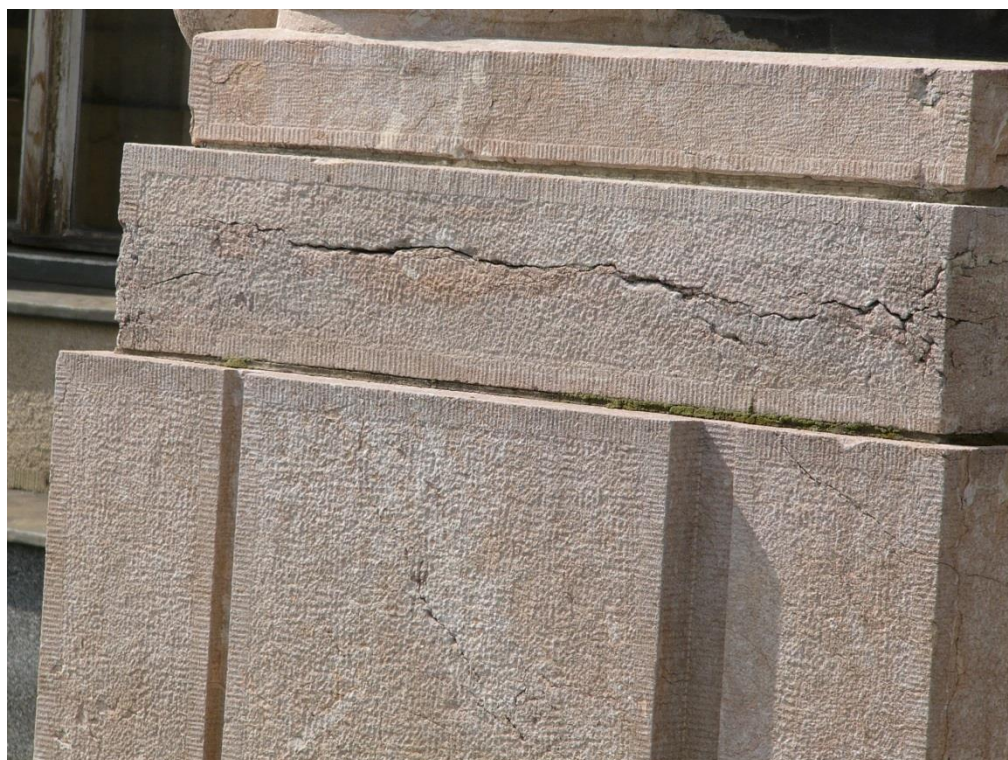
Detail soklu: statické praskliny na kamenných kvádrech soklu
