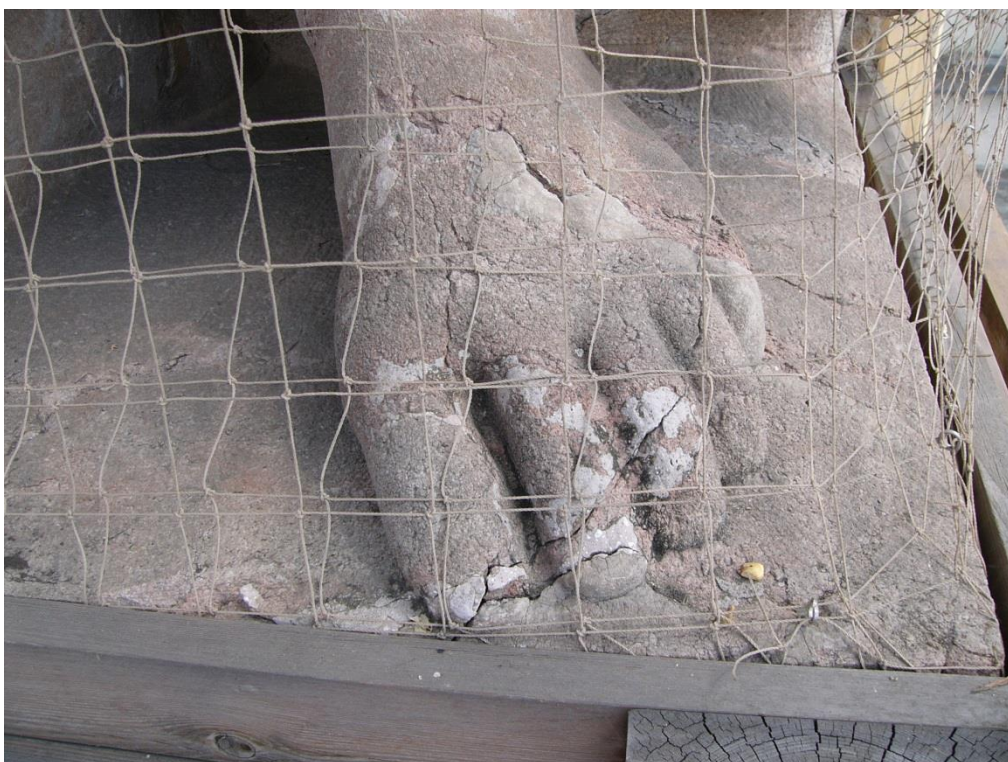
Detail levé nohy: destruktivní trhliny táhnoucí se přes nohu a plintus sochy
