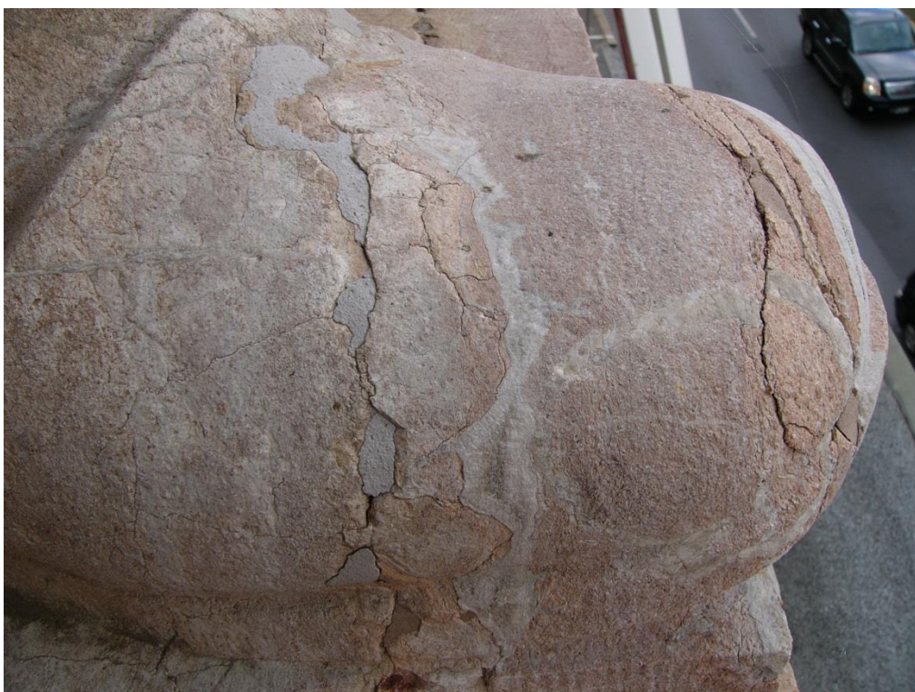
Detail pravé boty: statické trhliny probíhající skrz pravou botu
