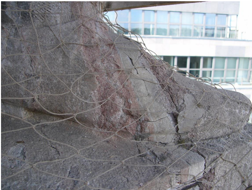
Detail pravé boty: statické trhliny trhající jak plintus tak sochu samou
