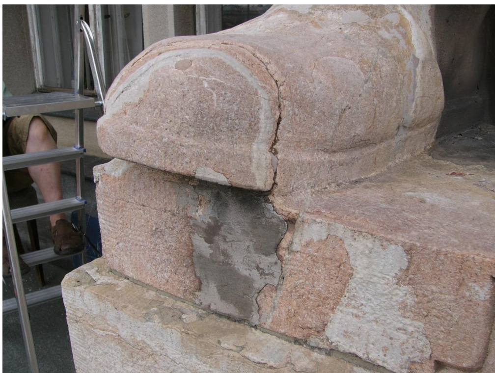
Pravá bota: trhlina probíhající skrz plintus a špičku boty, menší praskliny v celé ploše
