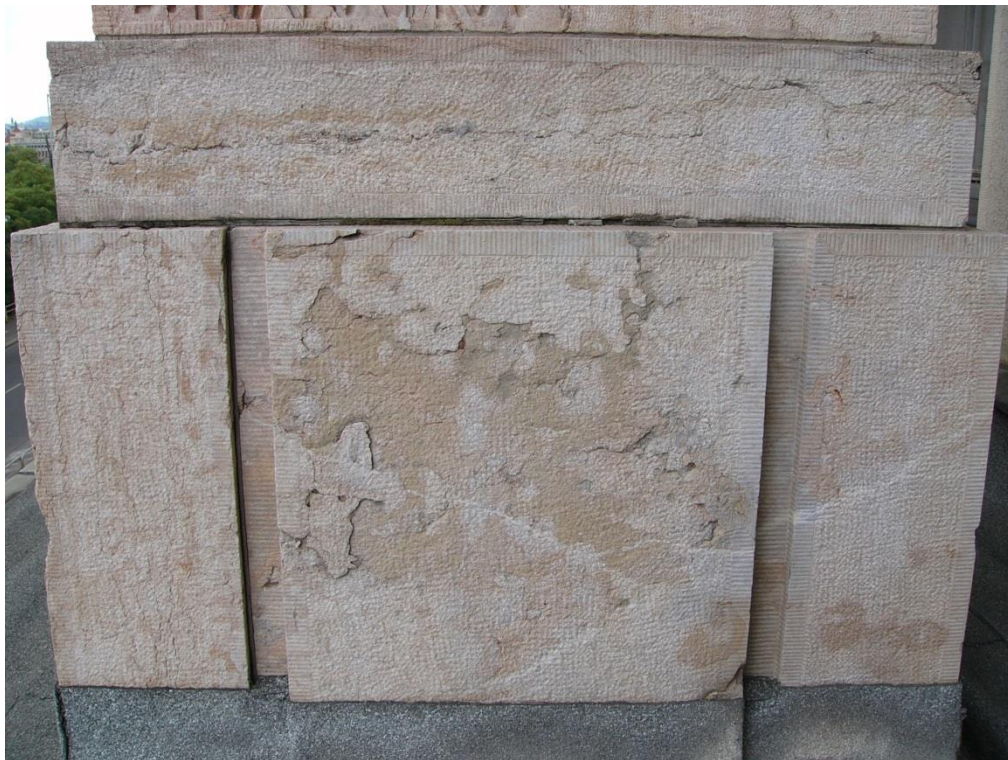
Sokl sochy z levé strany: statické trhliny a degradace kamene v kvádrech soklu
