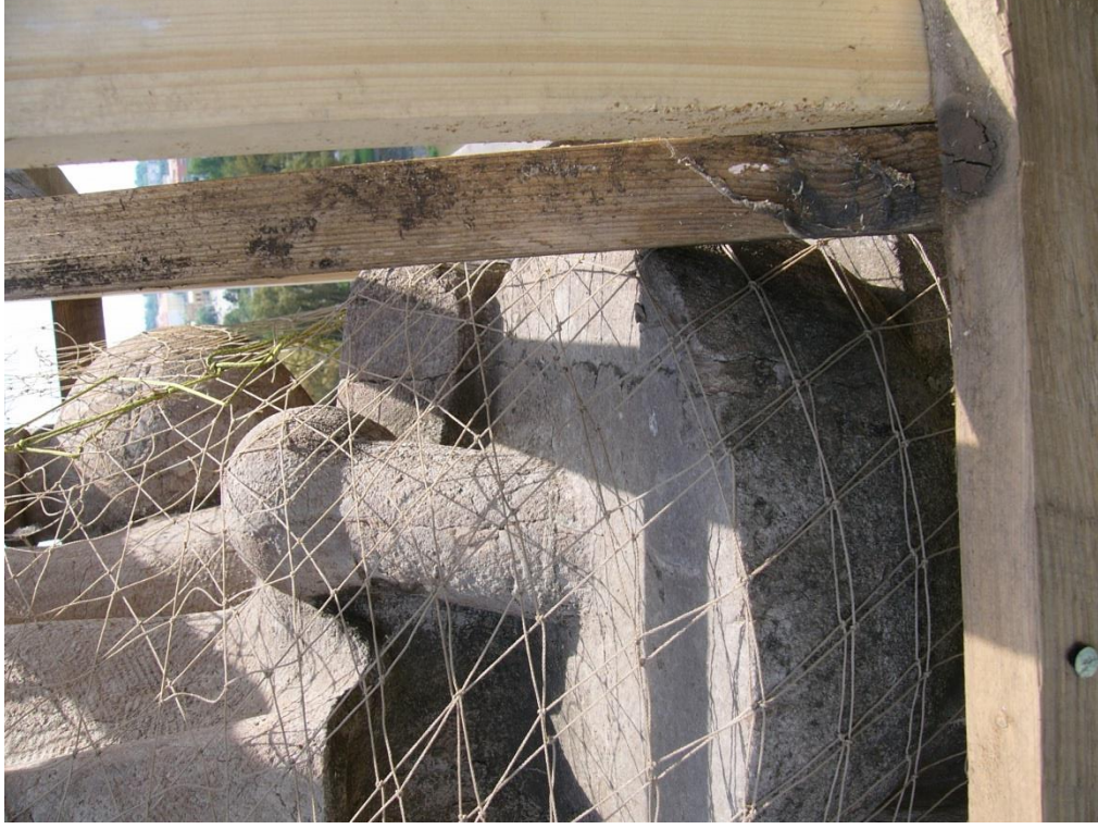
Hmoždíř z levé strany, z levoboku: trhliny táhnoucí se po celé šířce sochy , drobné praskliny po celé ploše
