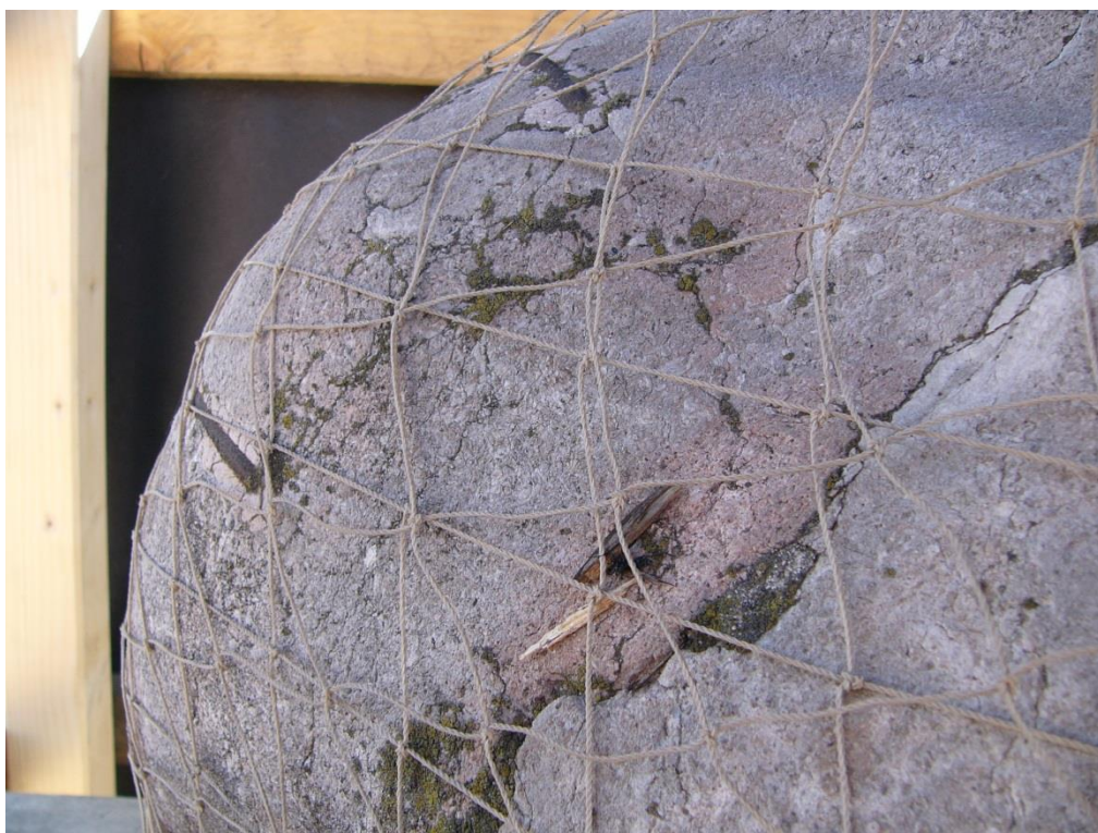
Pravé rameno: množství trhlín po celé oblasti ramene, zajišťovací kramlíčky, lišejníky
