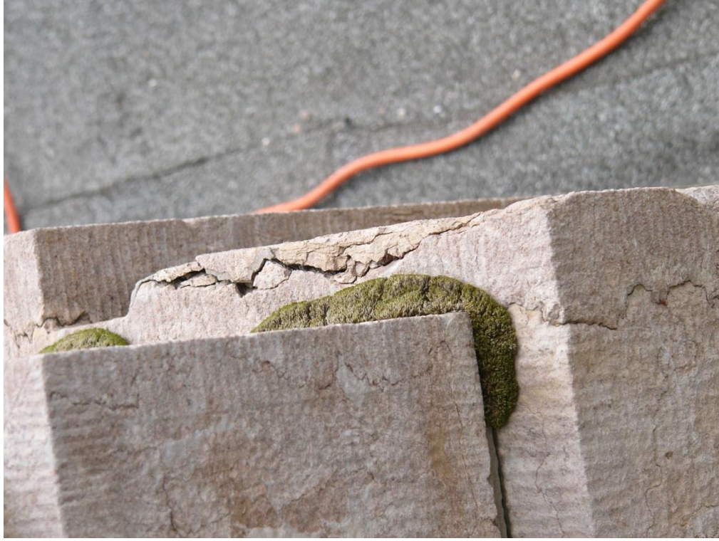
Detail soklu: odpadávající hmota materiálu z kamenných kvádrů soklu
