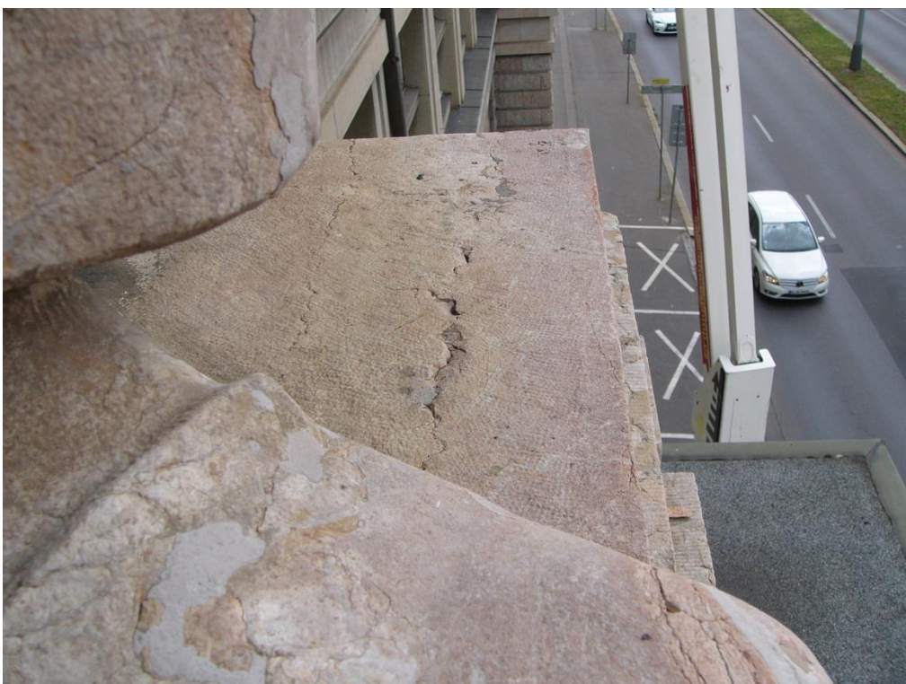
Detail pravé boty a plintu sochy: trhliny táhnoucí se přes celý plintus a částí sochy
