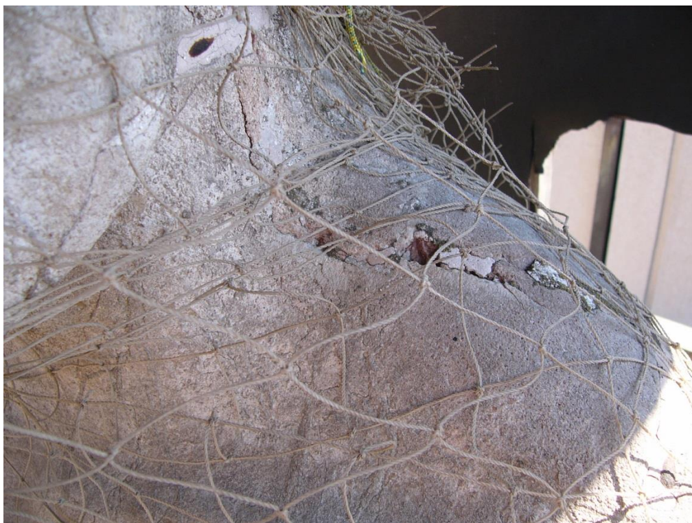
Levé rameno: statická trhlina, pavučiny drobných prasklin
