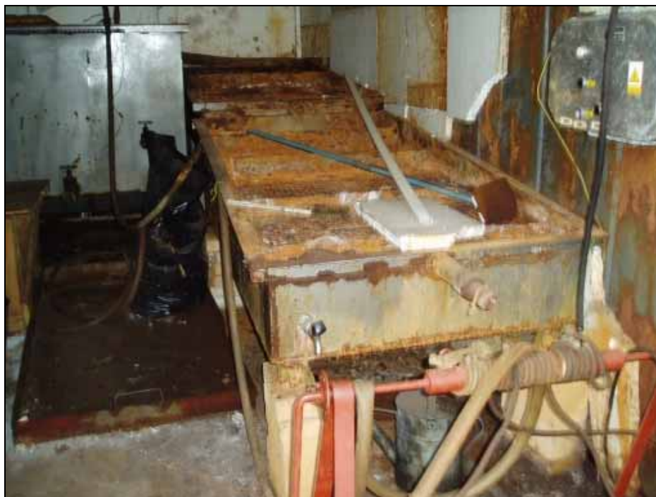
foto č. 12: Vnitřní prostor sanační stanice.
