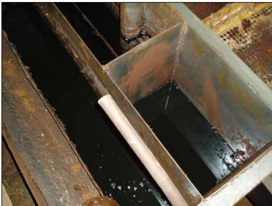
foto č. 11: Zbytek fáze v odsedací nádrži v sanační stanici.
