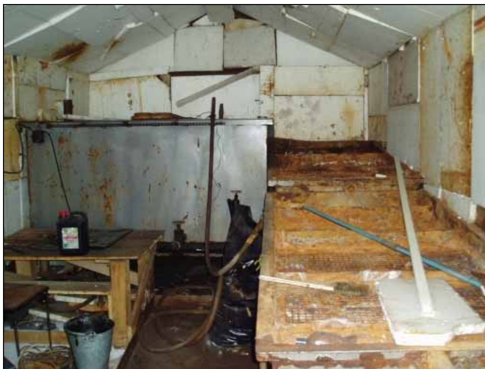
foto č. 10: Vnitřní prostor sanační stanice.
