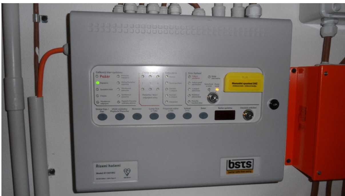
Ústředna stabilního plynového hasicího zařízení
