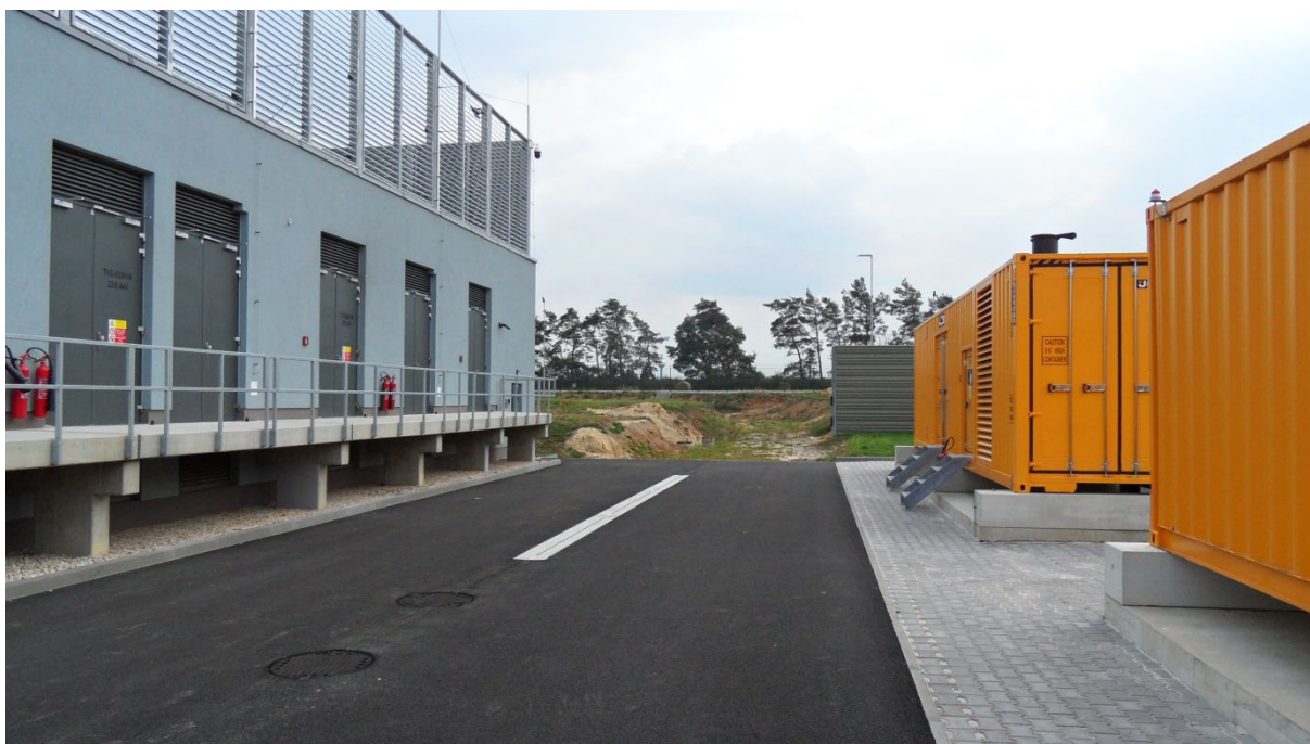
Vlevo zadní část budovy datového centra s trafostanicemi, vpravo energocentrum
